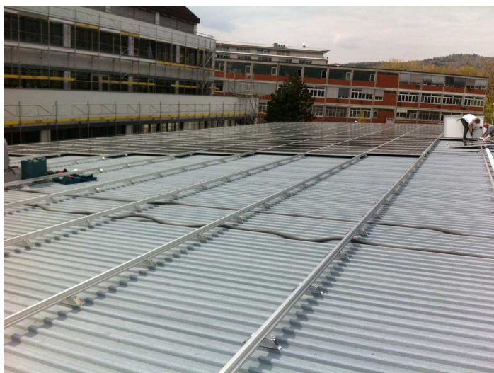
Ausführung, Foto: Sunconnect GmbH, Thalwil, Inbetriebnahme Juni 2013
