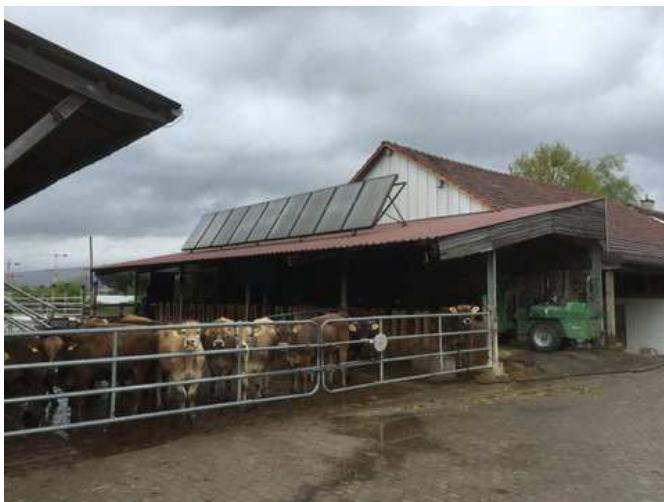
Sonnenkollektoren Spahn, Foto S. Spahn
